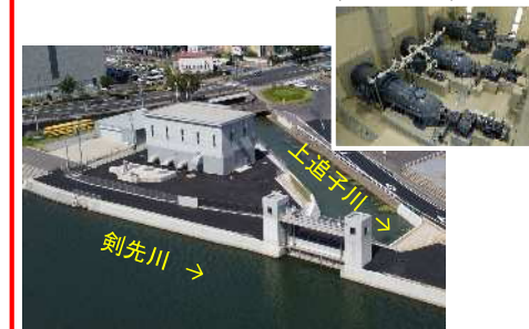
上追子川排水機場（R3.9完成）
