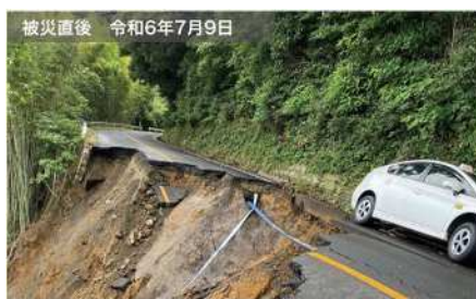
被災状況写真
