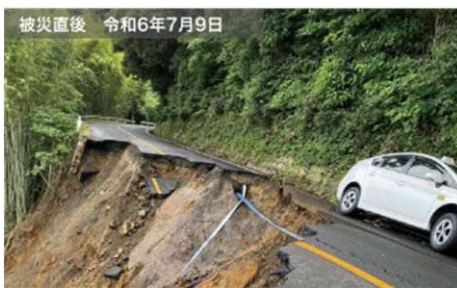
被災状況写真
